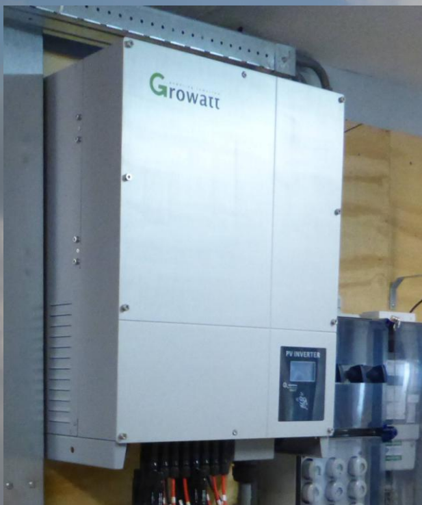
Een van de omvormers van de zonne-energie installatie
